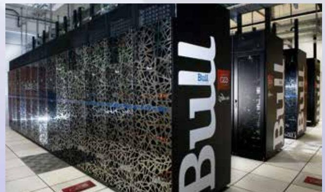
Supercalculateur TERA 1000-1, en service sur le centre DAM/Ile-de-France (2016).
